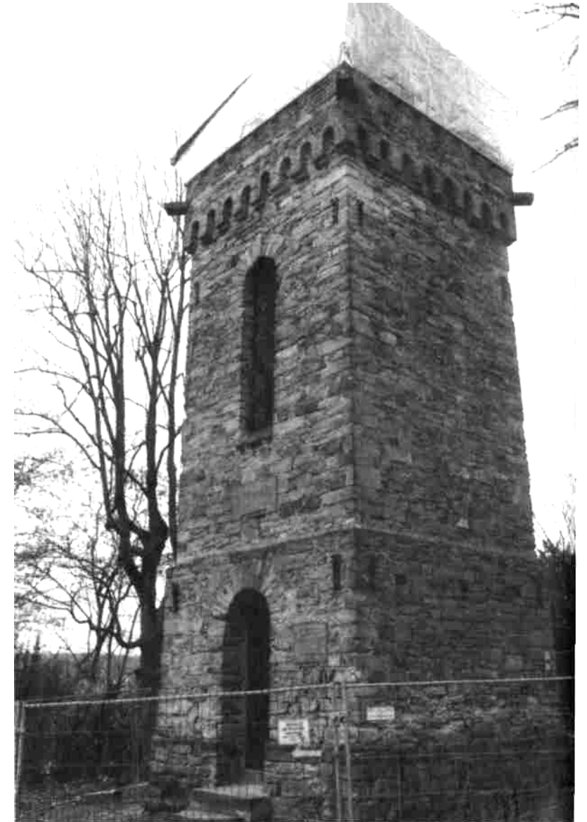
Der zehn Meter hohe Aussichtsturm auf dem zum Alten Kurpark gehörenden Burgberg oberhalb der Parkstraße wird saniert. Wegen akuter Schäden ist das Bauwerk umzäunt.
